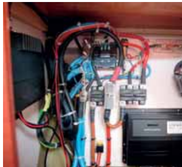
De bekabeling achter de zekeringskast is zeer robuust uitgevoerd.
