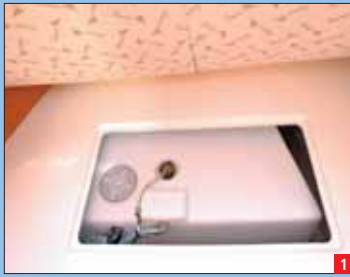
Bajo la cama de proa se encuentra el depósito de agua potable.
