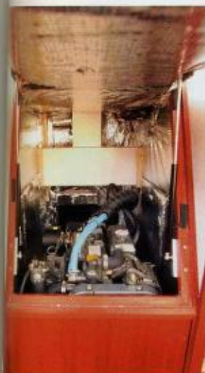
De afdekking maakt de motor moeilijk toegankelijk voor onderhoud.
