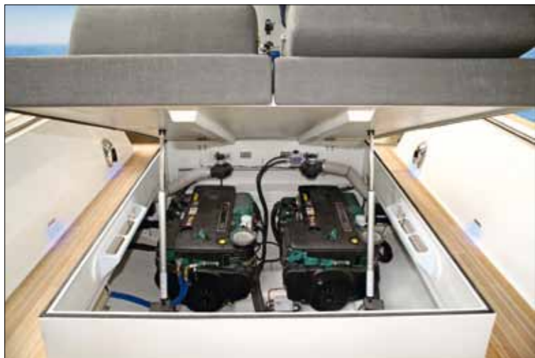
Les D4 montés contre la cloison ménagent beaucoup d'espace libre dans la cale.
